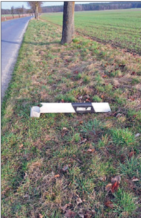
Vandalismus, viele Begrenzungspfähle werden einfach umgestoßen oder rausgerissen
